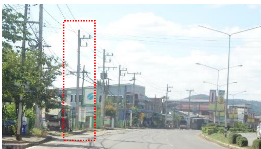
ระบบไฟฟ้าของการไฟฟ้าส่วนภูมิภาค
