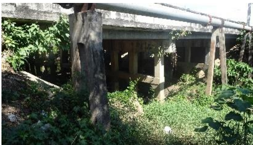
สภาพทั่วไปบริเวณสะพานข้ามคลองหินเหล็กไฟ
