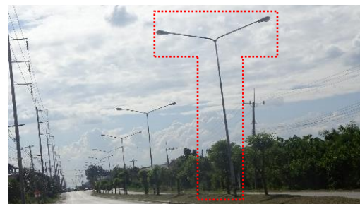
ระบบไฟฟ้าส่องสว่างเกาะกลางและริมทางหลวง
